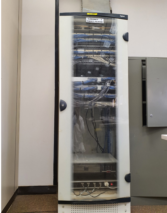
الشكل رقم (١١). خزانة موزعات شبكة الكمبيوتر (switch rack cabinet). المصدر: الباحثون.
